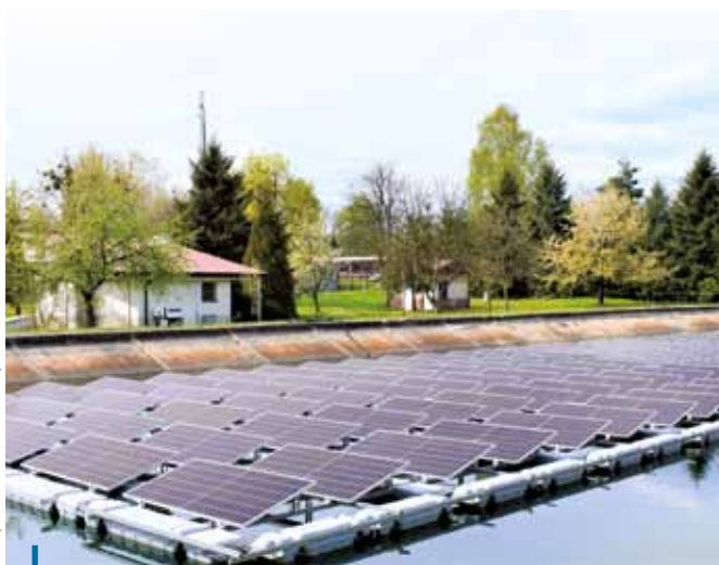
SUW TRZEBIONKA. Pływająca instalacja PV.
